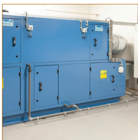
INSTALAÇÕES DE CLIMATIZAÇÃO
