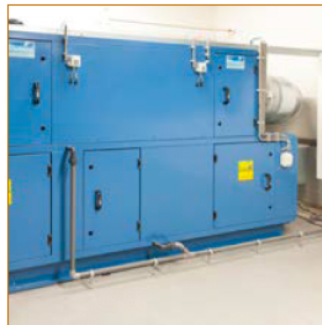
IMPIANTI DI CONDIZIONAMENTO
