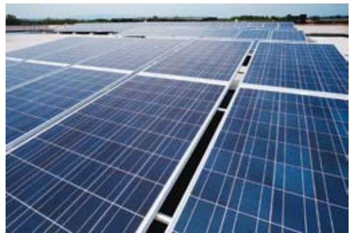
De 19 kWp fotovoltaïsche zonne-energie-installatie dient om de belangrijkste afdelingen van Caleffi te voorzien van energie.
